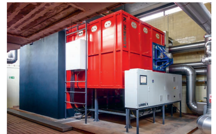
Kleiner Prototyp des Stahlspeichers in Berlin-Tegel
